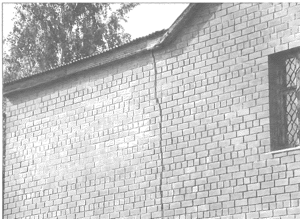
Причина появления таких трещин в стенах – незаглубленный или мелкозаглубленный фундамент и слабое армирование самих стен
